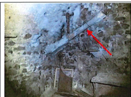
Photo n° PhA001 Localisation : Rez de chaussée - Garage Ouvrage : Conduits de fluides (air, eau, autres fluides) Partie d'ouvrage : Conduits Description : Conduits Localisation sur croquis : M001
